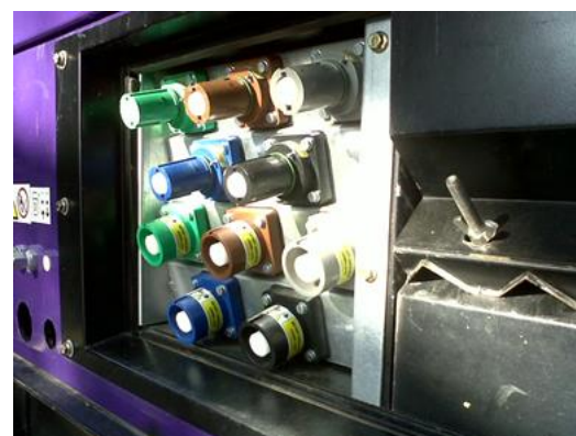
Pack prises Powerlock sur notre groupe 200 kva.
