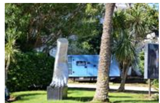
Groupe électrogène 200 kva et climatisation, Gotha Cannes
