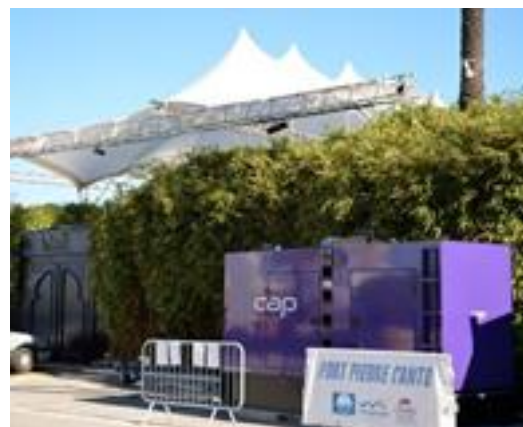
Groupe électrogène 275 Kva. Bâoli, Cannes
